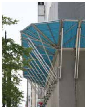
工事現場の"アサガオ"
