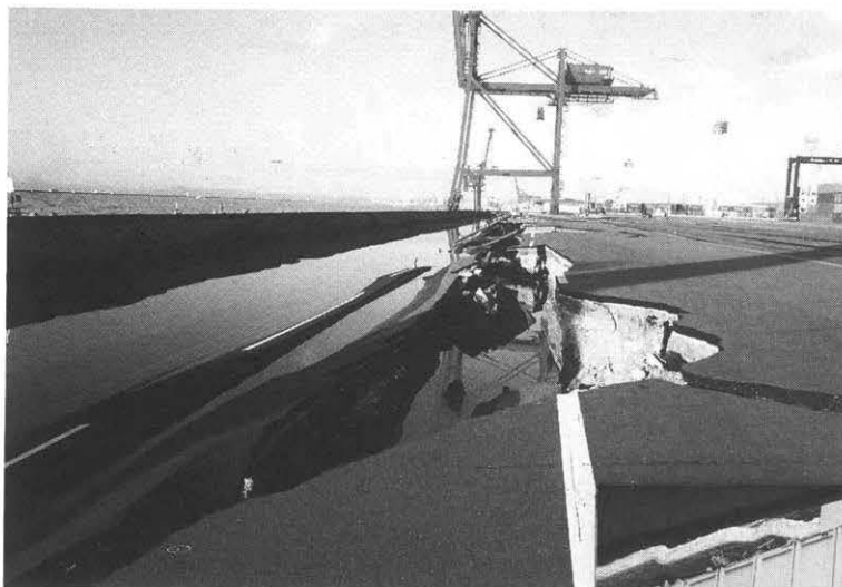
●液状化現象によって道路が陥没した六甲アイランド
