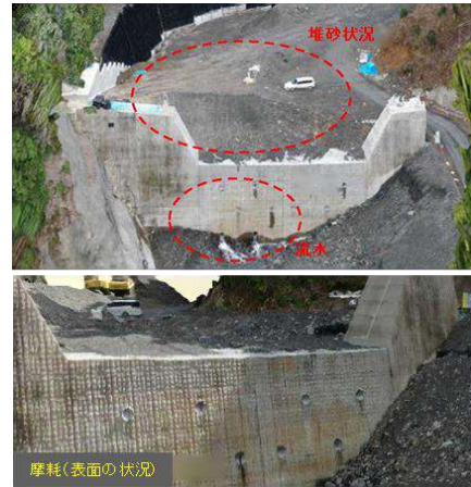
図-5 3次元モデルによる堰堤の変状推定
