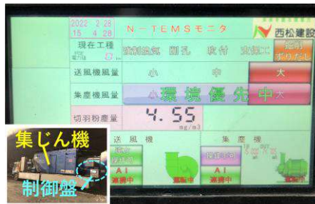
図-3 集じん機に設置された制御盤のタッチパネル
