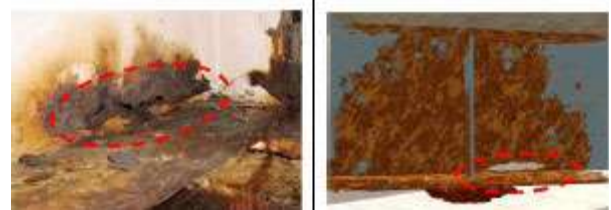
図-3 主桁の腐食写真(左) 3Dモデル(右)
