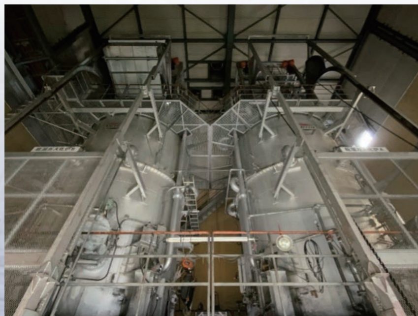
乾溜ガス化式焼却炉
