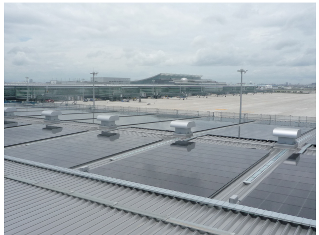
図13 太陽光パネル
