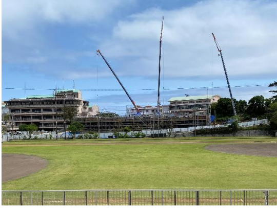
▲建設中のふれあい交流センター（総合グラウンド側より）
