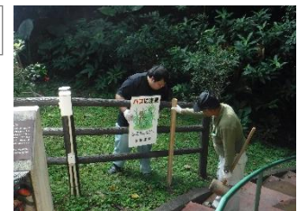
危険生物についての注意看板設置
