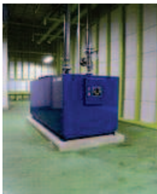
エチレン吸着器 (C 2 H 4 除去)
