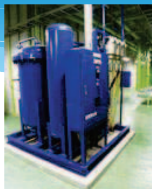
窒素発生機 (O 2 濃度調整)
