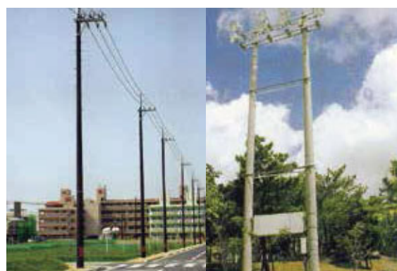
電力送電用ポール(左)
