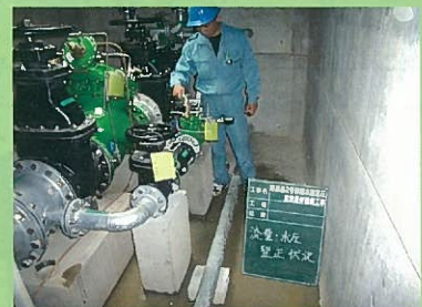
定圧定流量弁を設置終了。水圧、流量を設定し管路破損を防ぎます。
