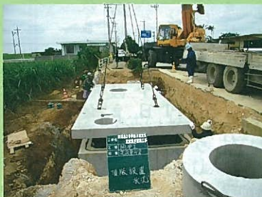
定圧定流量弁は地下に埋設するため、弁室を設置します。
