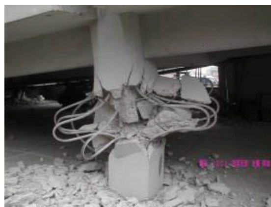
写真 2.6 放射状に飛び出して座屈した主筋
