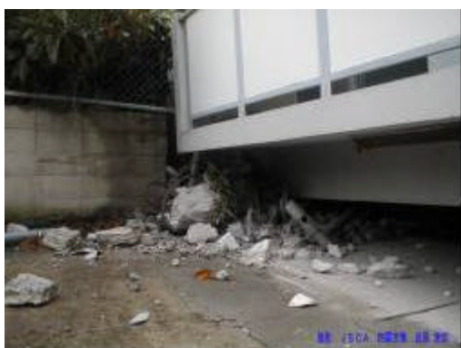
写真 2.3 南西端柱の破壊状況
