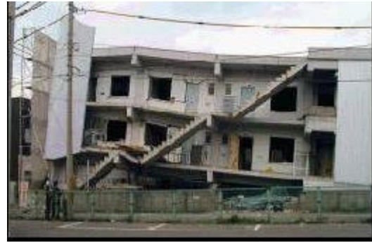
写真 1 倒壊した対象建物
