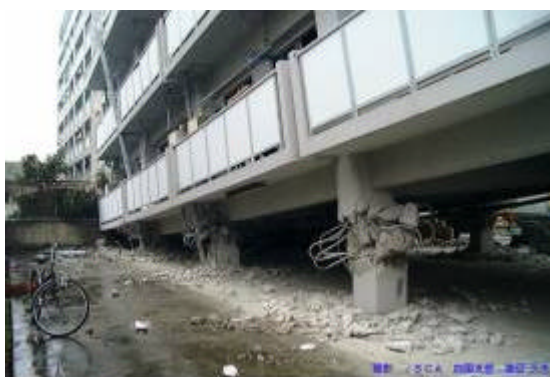
写真 2.4 1階南構面の落階状況
