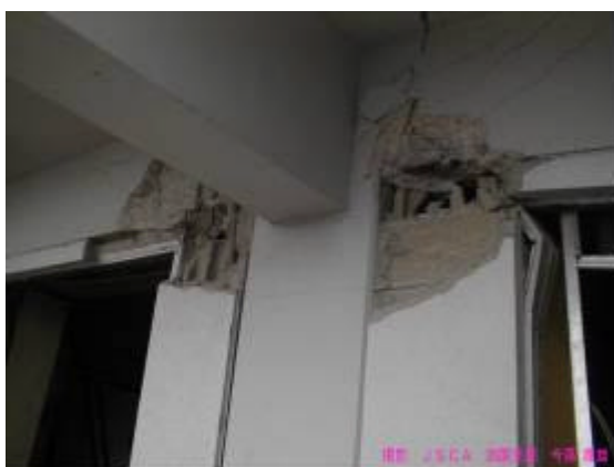
写真 2.5 2階北構面袖壁の被害状況
