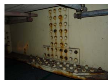
f) ボルト継手部の腐食
