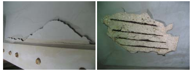
写真-3 夫婦橋劣化状況 (1)
