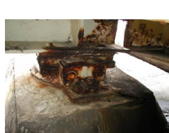
e) 鋼支承部の腐食
