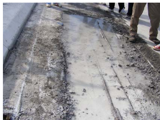
写真3 床版の塩害損傷状況
