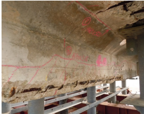
写真-1 W-1 の損傷写真
