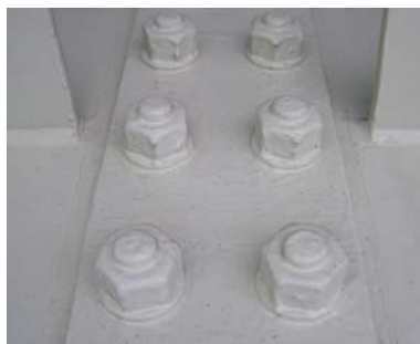
写真3 暴露試験体ナット部
