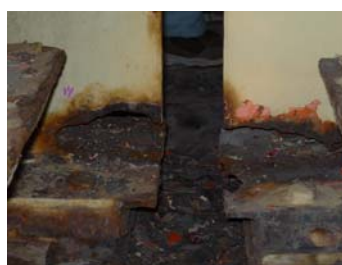
b) 桁端部の腐食①
