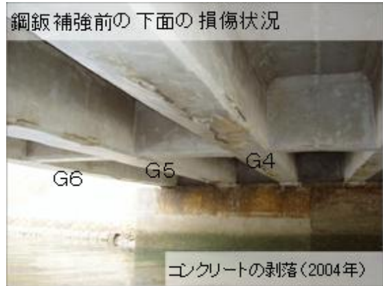
写真6 コンクリート桁の損傷状況
