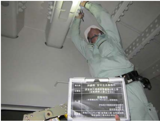
写真-5：塗膜割れの確認状況
