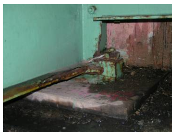
d) 桁端部の腐食③
