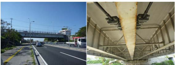
写真3 大平インター陸橋劣化損傷状況
