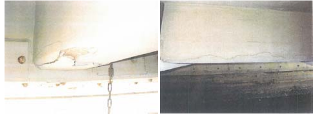
写真-4 夫婦橋劣化状況 (2)
