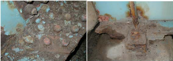
写真2 那覇大橋劣化損傷状況(2)
