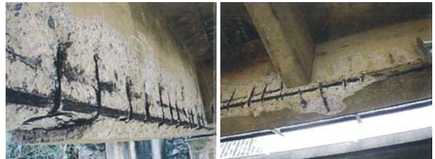
写真-1 高平橋劣化損傷状況(1)
