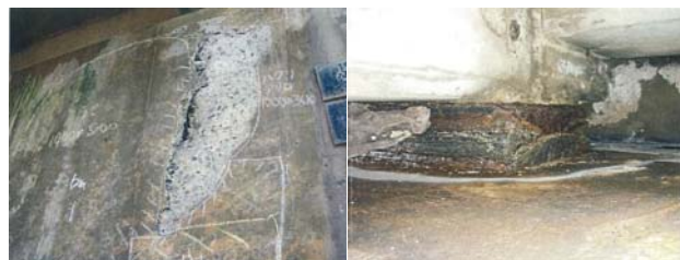
写真-2 高平橋劣化損傷状況(2)
