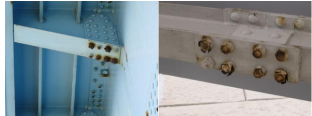
写真1 腐食した高力ボルト継手部
