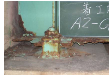
c) 桁端部の腐食②
