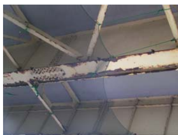
a) 下フランジエッジ部の腐食
