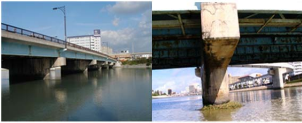
写真1 那覇大橋損傷状況(1)
