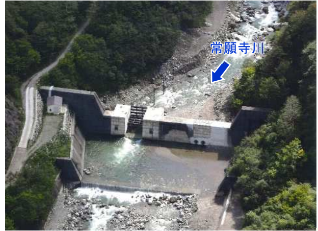
▲国内初のシャッター付砂防堰堤 妙寿砂防堰堤
