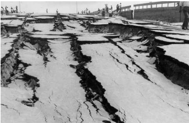
写真-3 昭和大橋の被害状況 文献2)
