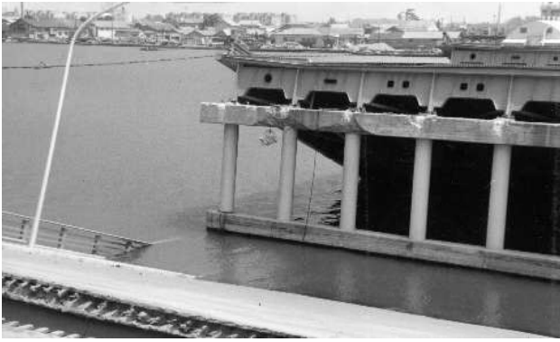
写真-2 昭和大橋の落橋被害状況 文献2)
