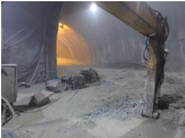
道路陥没発生経緯【時系列】
