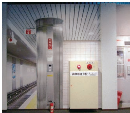
写真5 非常停止合図装置・屋内消火栓
