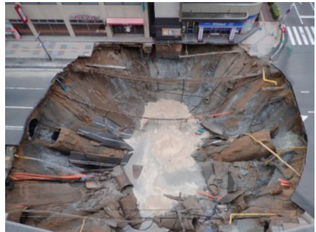
①道路陥没
