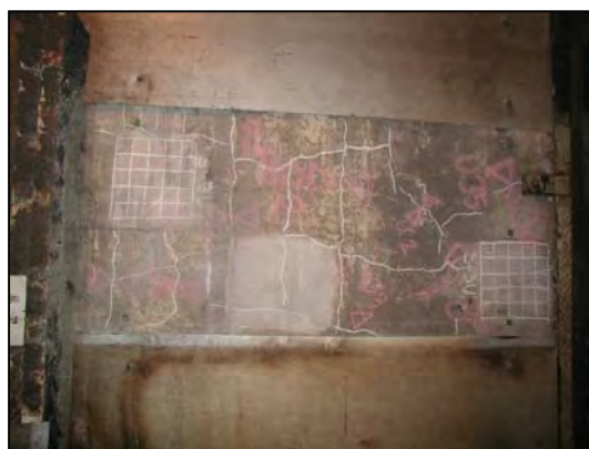
参写真 2.4.2 コンクリートの劣化状況
