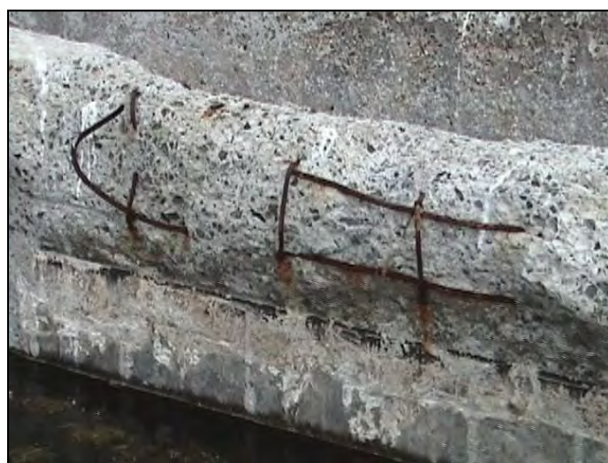
参写真 2.2.2 コンクリートの劣化状況
