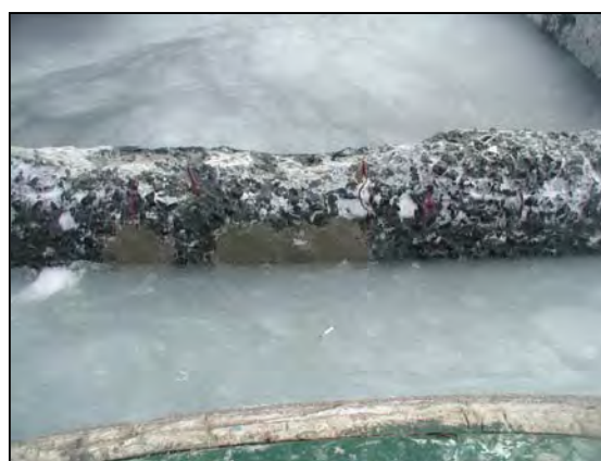
参写真 2.2.1 コンクリート表面の劣化状況
