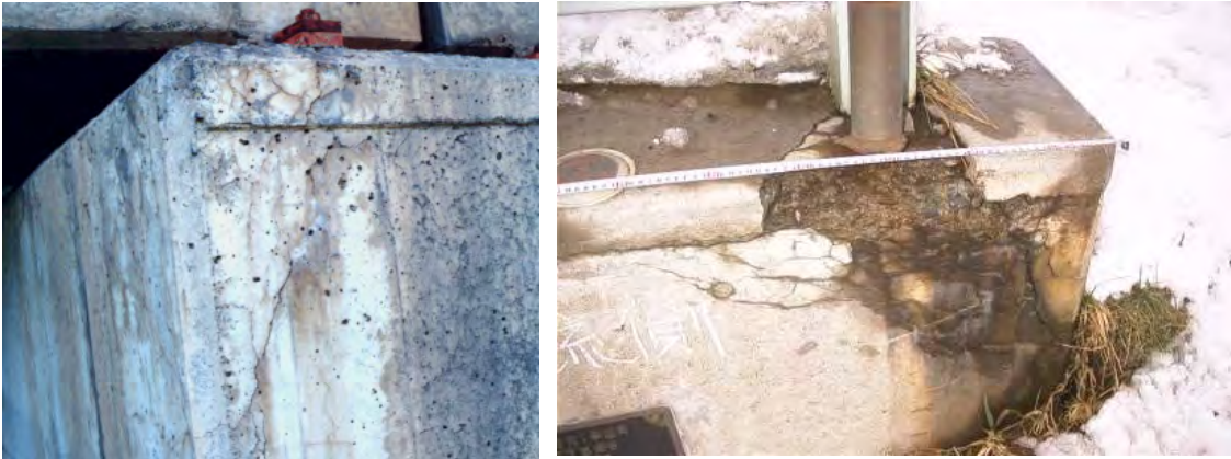
写真 2.1.6 凍結融解によるひび割れ
