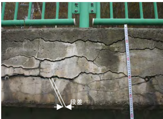
ひび割れ部の段差
