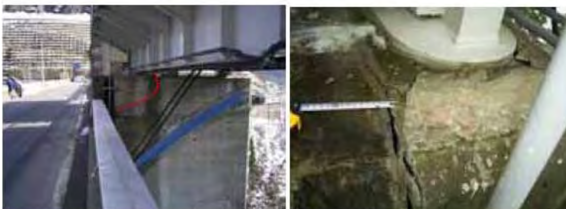
参写真 2.4.4 堰注全景とひび割れ部の拡大
