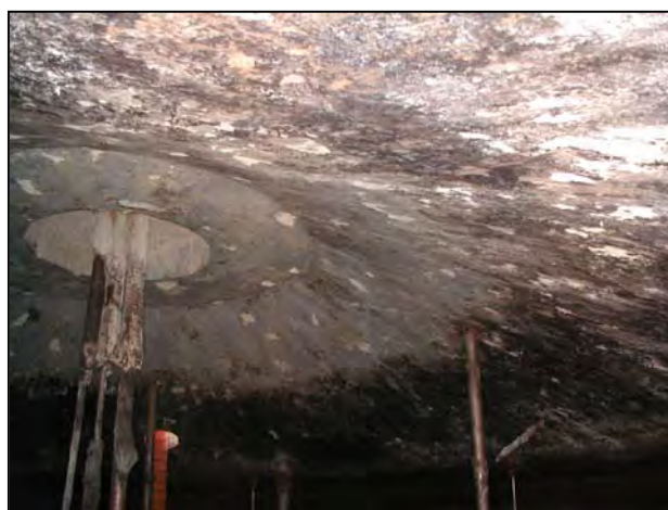
参写真 2.4.1 コンクリートの劣化状況
