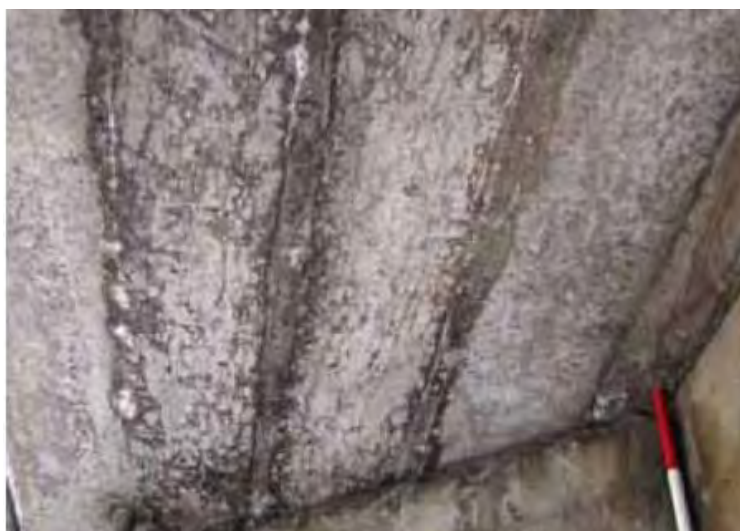
参写真 2.3.1 PCプレキャスト桁下面のひび割れ
