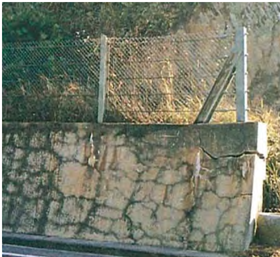
無筋コンクリートの亀甲状ひび割れ 5)
