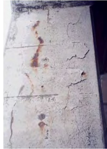
写真 2.1.3 鉄筋腐食によるかぶりコンクリートのはく離
