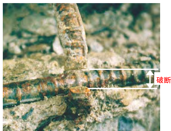
写真 3.7.1 ASRによる鉄筋破断
