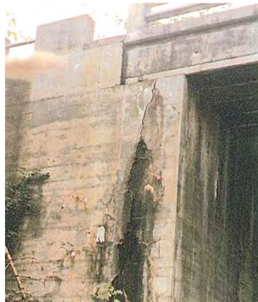
水分供給の多い箇所でのひび割れ 5)
