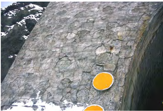
写真 2.1.10 凍害と塩害の複合劣化によるスケーリング
