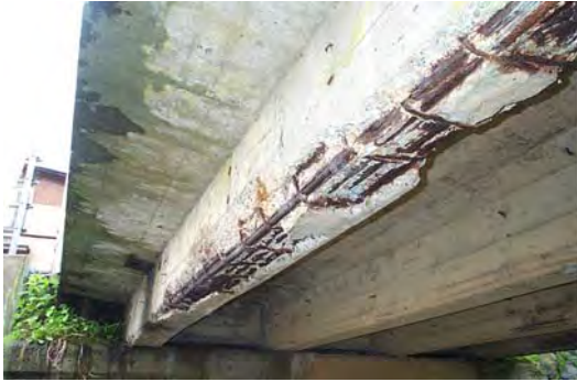
写真 2.1.2 鉄筋腐食によるかぶりコンクリートのはく落
