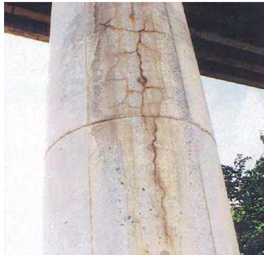
主筋方向のひび割れ 6)
