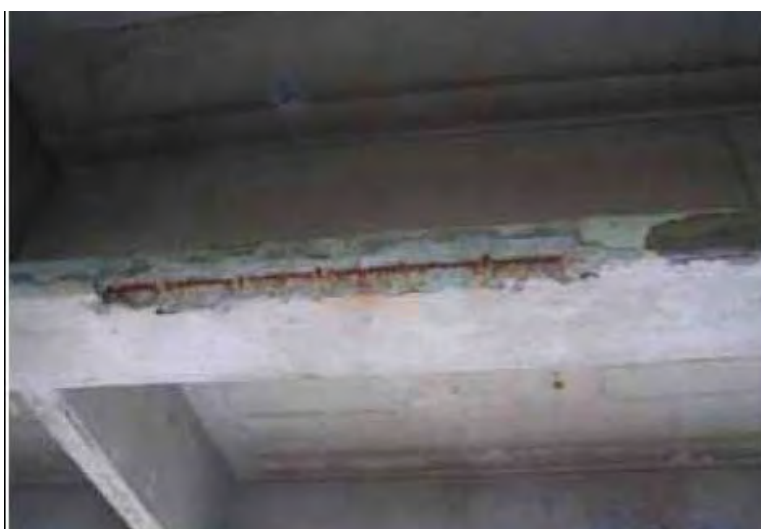
参写真 2.1.2 桁下面の塩害損傷状況（はく離・鉄筋露出）
