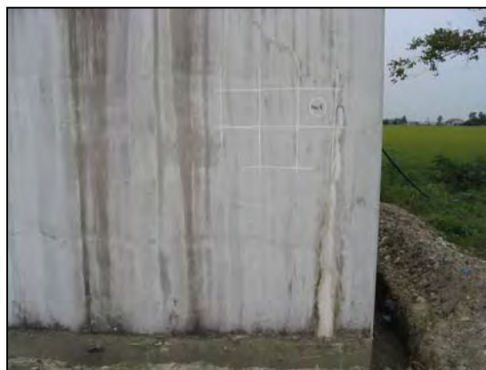
参写真 2.4.5 コンクリートの劣化状況
