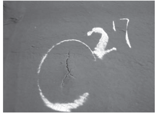
写真-3 プリスタリング発生状況
