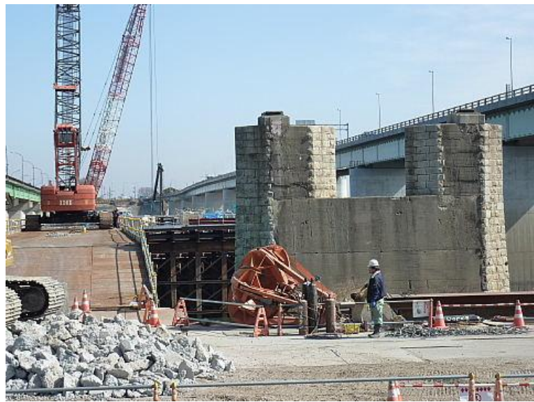
33 大正9年の鉄橋基礎杭を撤去中 設置には複数年を要したが撤去は数か月で完了とか
