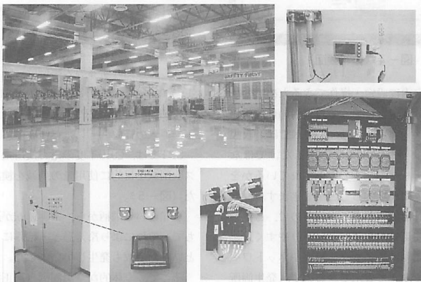
写真-1 空調制御
