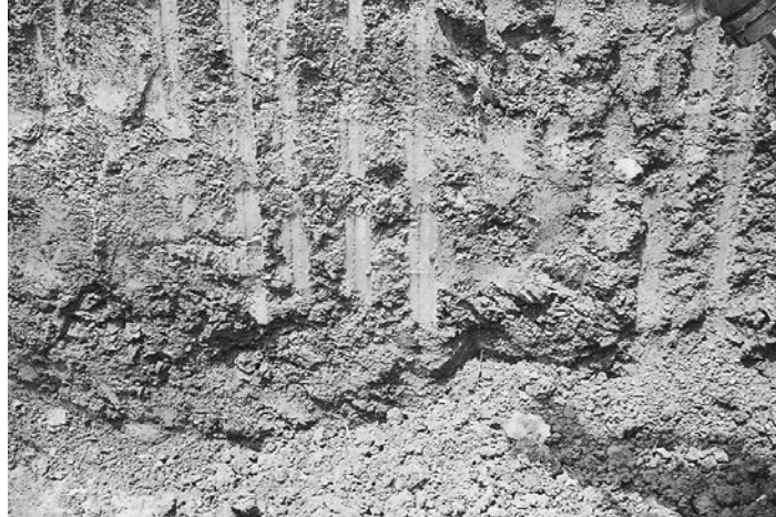
写真5. 葉山層群森戸層の泥岩 全体に破碎状をなし、浸水すると脆弱化著しい。 横須賀市秋谷にて。
