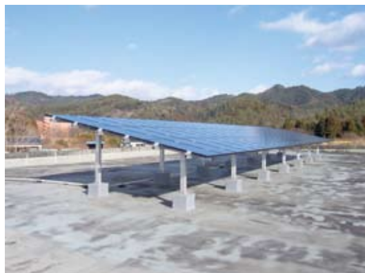
屋上のソーラーパネル
