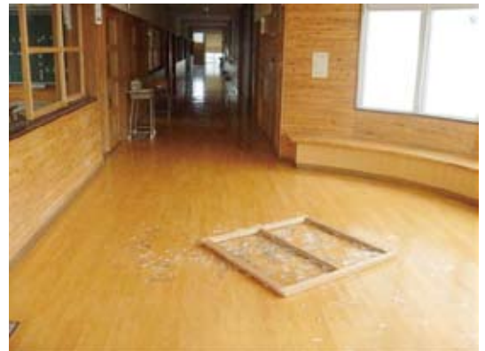
新月中学校の被害
