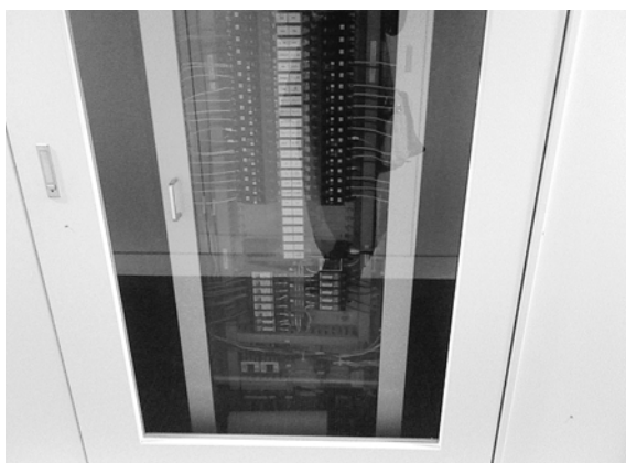
写真 - 3 見せる分電盤
