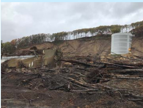
④富里浄水場の斜面崩壊による施設被害
