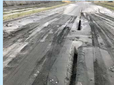
②道路の亀裂と陥没
