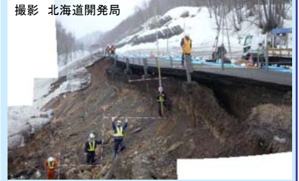
撮影 北海道開発局 国道230号(中山峠):平成25年4月に発生した盛土崩壊の様子
