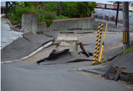
①液状化による土砂流出で 陥没したマンホール周辺地盤
