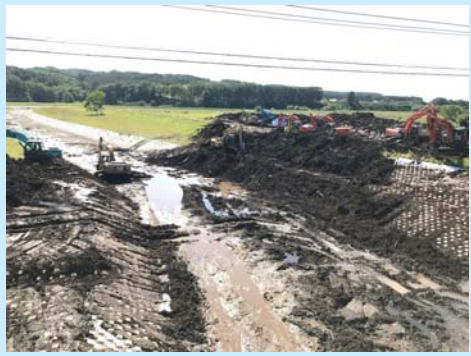
⑤崩壊土砂による厚真川河道閉塞撤去状況（幌内橋から撮影）
