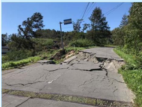
①道路側面での斜面崩壊により生じた道路の陥没（桜岡地区）
