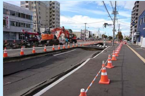
②道路の大規模沈下
