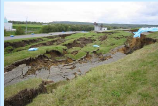
2003年十勝沖地震による河川堤防の被害。なお1993年釧路沖地震で被災した堤防で、強化復旧が行われた堤防は、この地震で被害は生じなかった。
