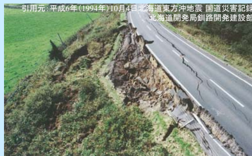
引用元:平成6年(1994年)10月4日北海道東方沖地震 国道災害記録 北海道開発局釧路開発建設部 1994年北海道東方沖地震による道路盛土の被害
