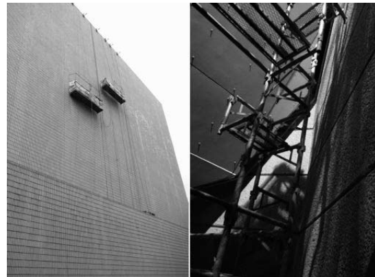
Fig.4 ゴンドラによる外壁調査 (左) 客席内全体に足場を組み立てて細部の調査・工事 (右)
